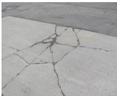
є – вибоїни у дорожньому покритті;
