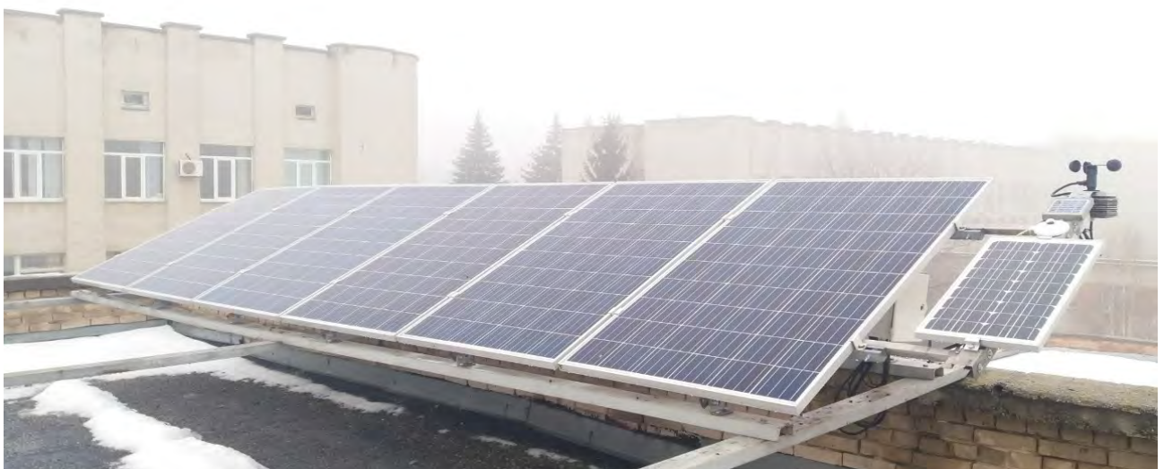
Рисунок 1.7 – Фотоелектрична станція 1.6кВт на будівлі ФЕЕЕМ ВНТУ
