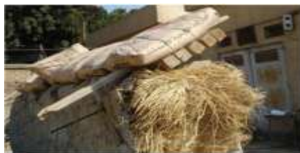
Рисунок 3 – Руйнація стіни А внаслідок нерівномірного навантаження [11]
