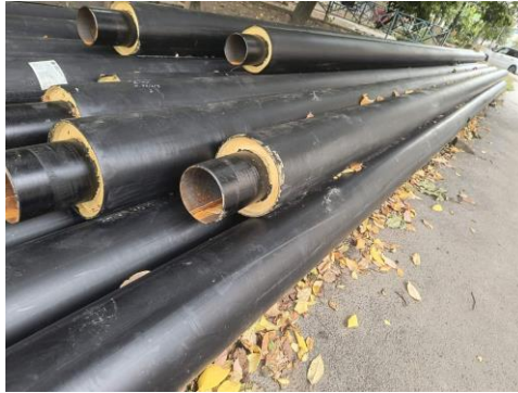
Рис. 2. – Приклад неправильного складування труб перед влаштуванням модернізації трубопроводу на вул. Ващука.
