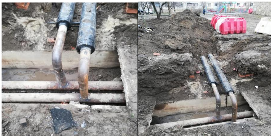
Рис. 1. Наглядний приклад неефективного використання попередньо ізольованих труб шляхом їх підключення до не утепленої теплової мережі, яка експлуатується з 1985 року.
