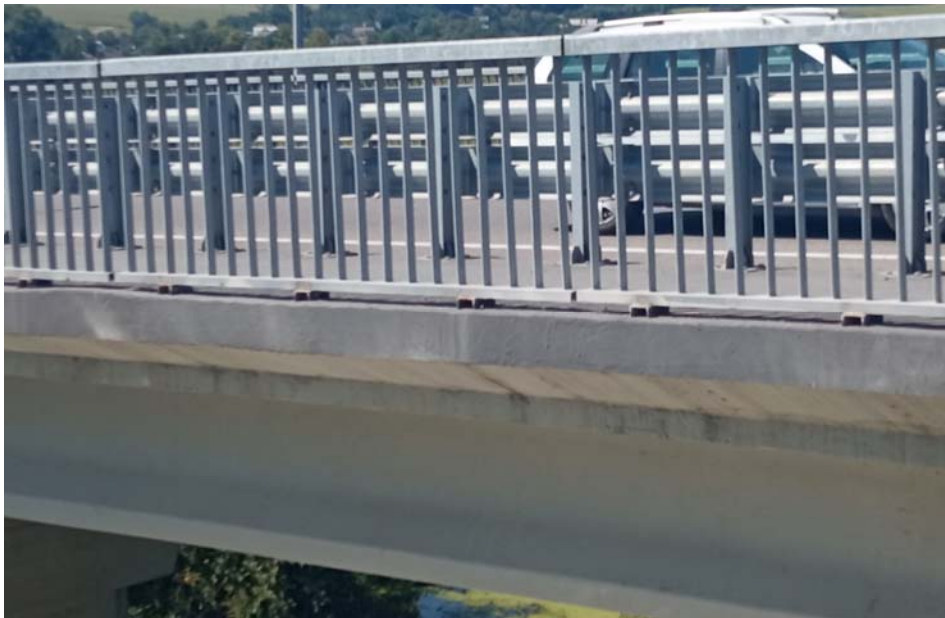
Рис. 5. Зовнішній вигляд балочної пролітної будови мосту через р. Сіб, м. Гайсин після реконструкції, в тому числі, після підсилення тротуарної частини полігональною накладною плитою.
