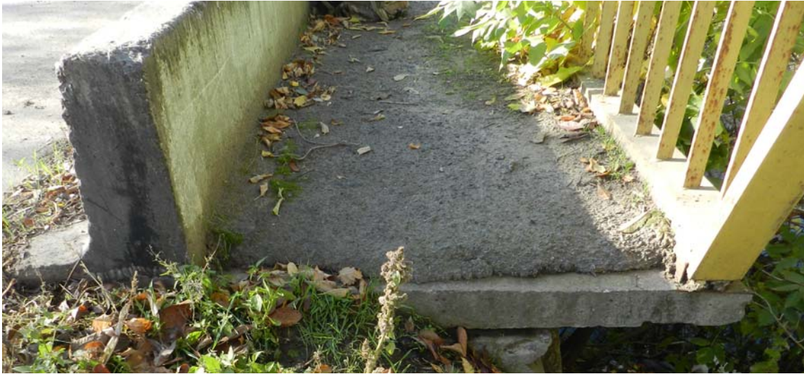
Рис. 1. Зовнішній вигляд та стан існуючих типових тротуарних конструкцій у вигляді збірної ребристої плити на прикладі мосту через р. Удич, с. М'якохід, Вінницька область. Ширина тротуару не відповідає вимогам чинних норм [5]. Конструкція бетонного бар'єрного огородження не відповідає вимогам норм [3].
