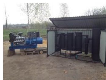
Рис. 3. Електростанція з газогенератором спадного потоку потужністю 30 кВт
