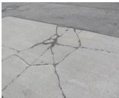
є – вибоїни у дорожньому покритті;
