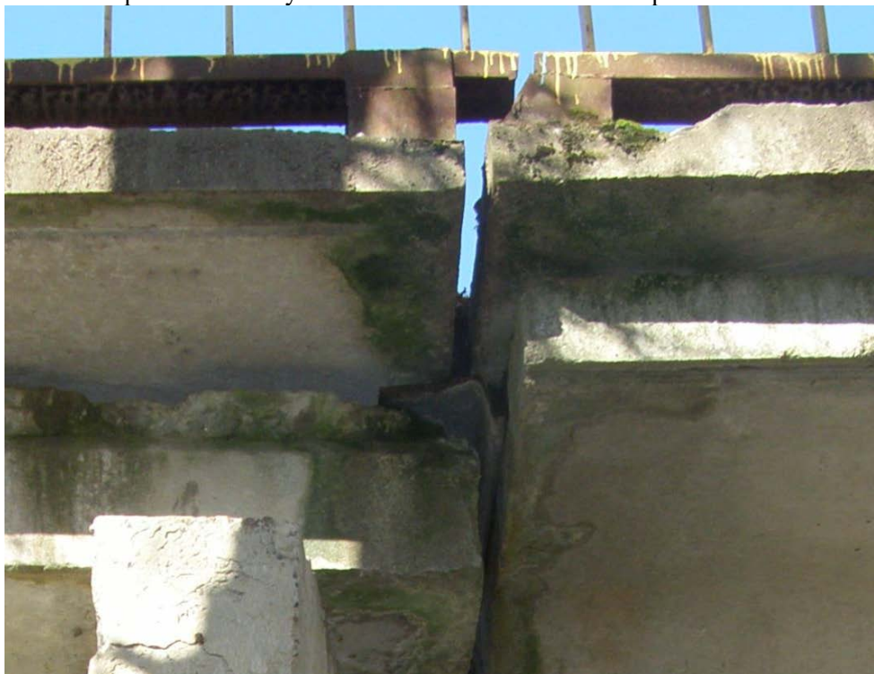
Рис. 2. Зовнішній вигляд та технічний стан деформаційного шва балочного мосту, збудованого у с. Удич, на дорозі Р-54. Руйнування ущільнювача шва. Сліди замокання суміжних бетонних конструкцій. Руйнування ділянок бетону поблизу швів внаслідок втрати морозостійкості.
