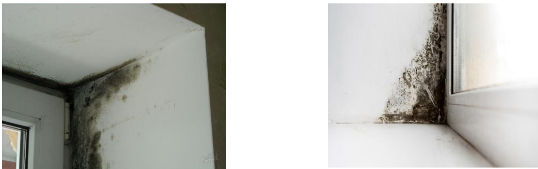
Рис. 1 Негативний вплив заміни віконних конструкцій на тепловологісний режим приміщень і зовнішніх огорожень
