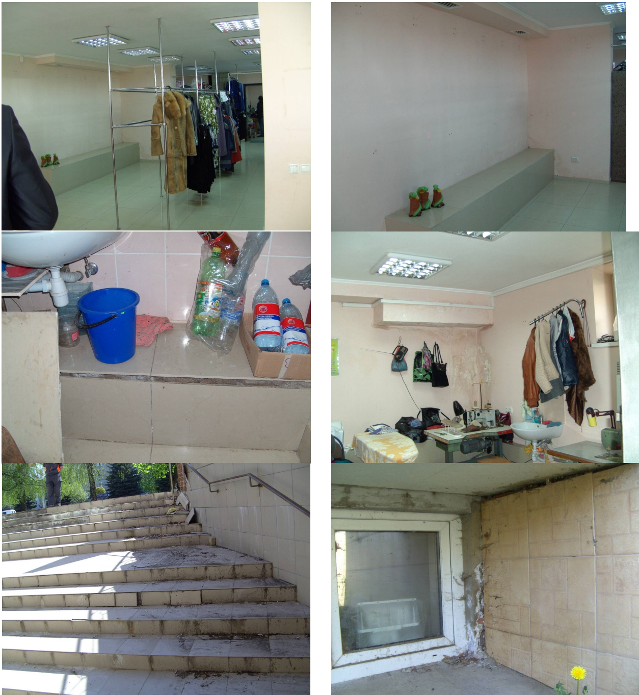
Рис. 4. Пошкодження елементів будівлі внаслідок дії стихійного лиха (злива)
