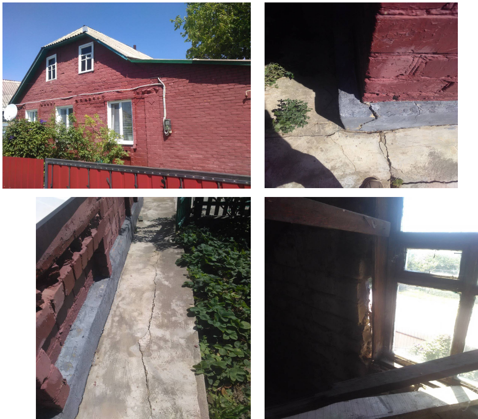
Рис. 2. Руйнування конструкцій внаслідок неправильної експлуатації. Житловий будинок у м. Жмеринка
