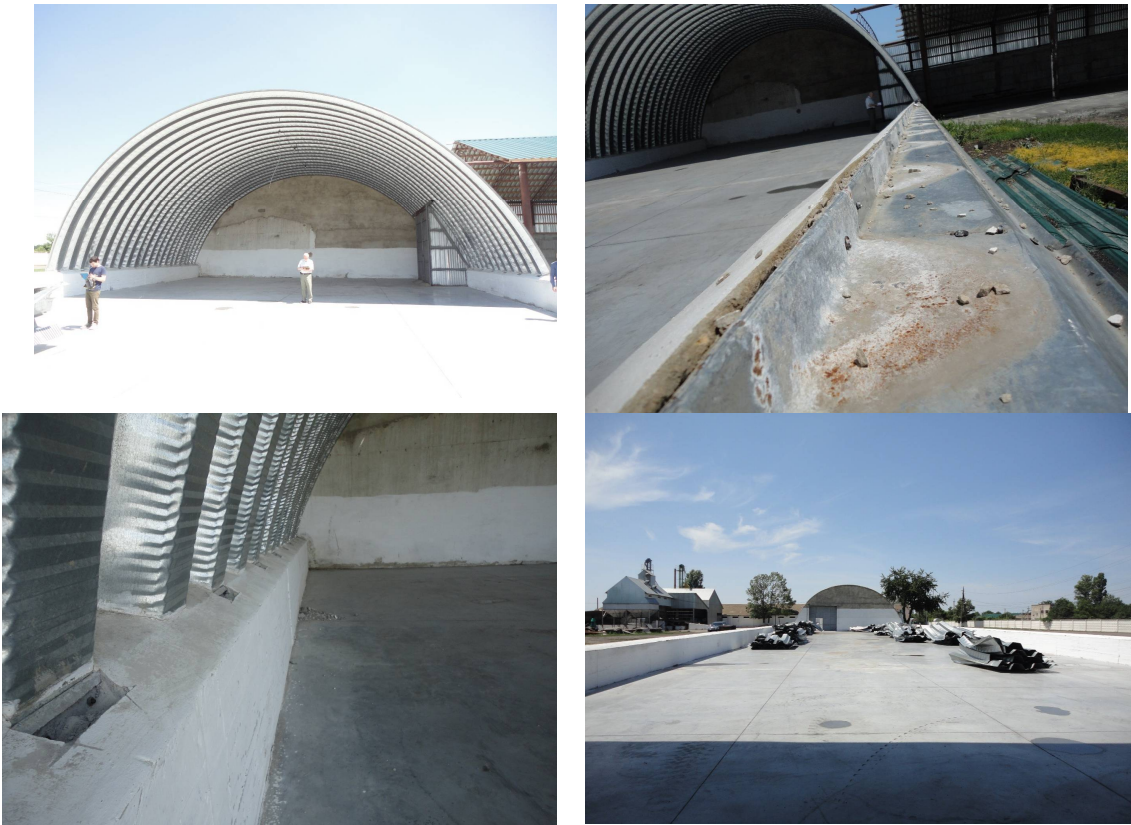
Рис. 1. Руйнування будівлі ангару (сmt. Бершадь) внаслідок неякісного виконання будівельних робіт
