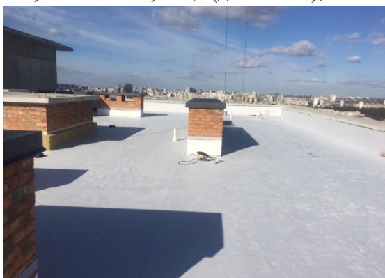
Рис.1 – Не експлуатована покрівля.
